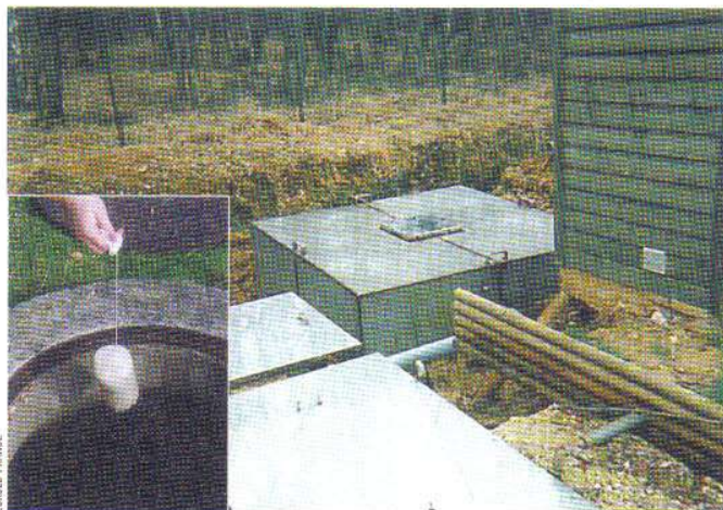
Ajoutées dans le bac à graisses, les bactéries sont une aide précieuse au traitement.
